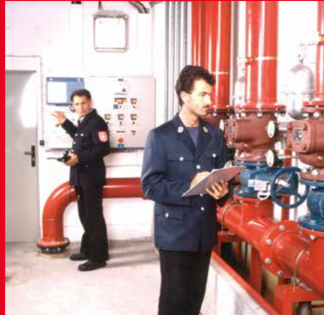
Eine wichtige Aufgabe der Werkfeuerwehr ist die Prüfung von Sprinkleranlagen. Das Foto entstand Mitte der 1980er-Jahre.
