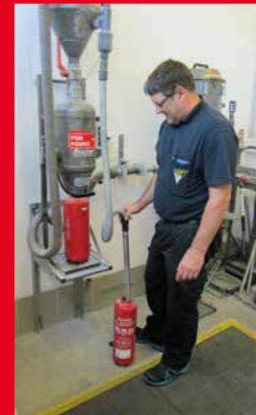
Die Wartung brandschutztechnischer Einrichtungen erfolgt durch die Spezialisten der Werkfeuerwehr.
