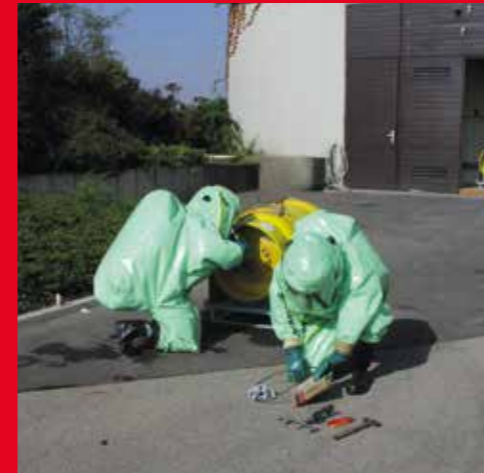
Chlorgasaustritt in Ulm: Abdichten der Leckage im Chemikalien-Schutzanzug
